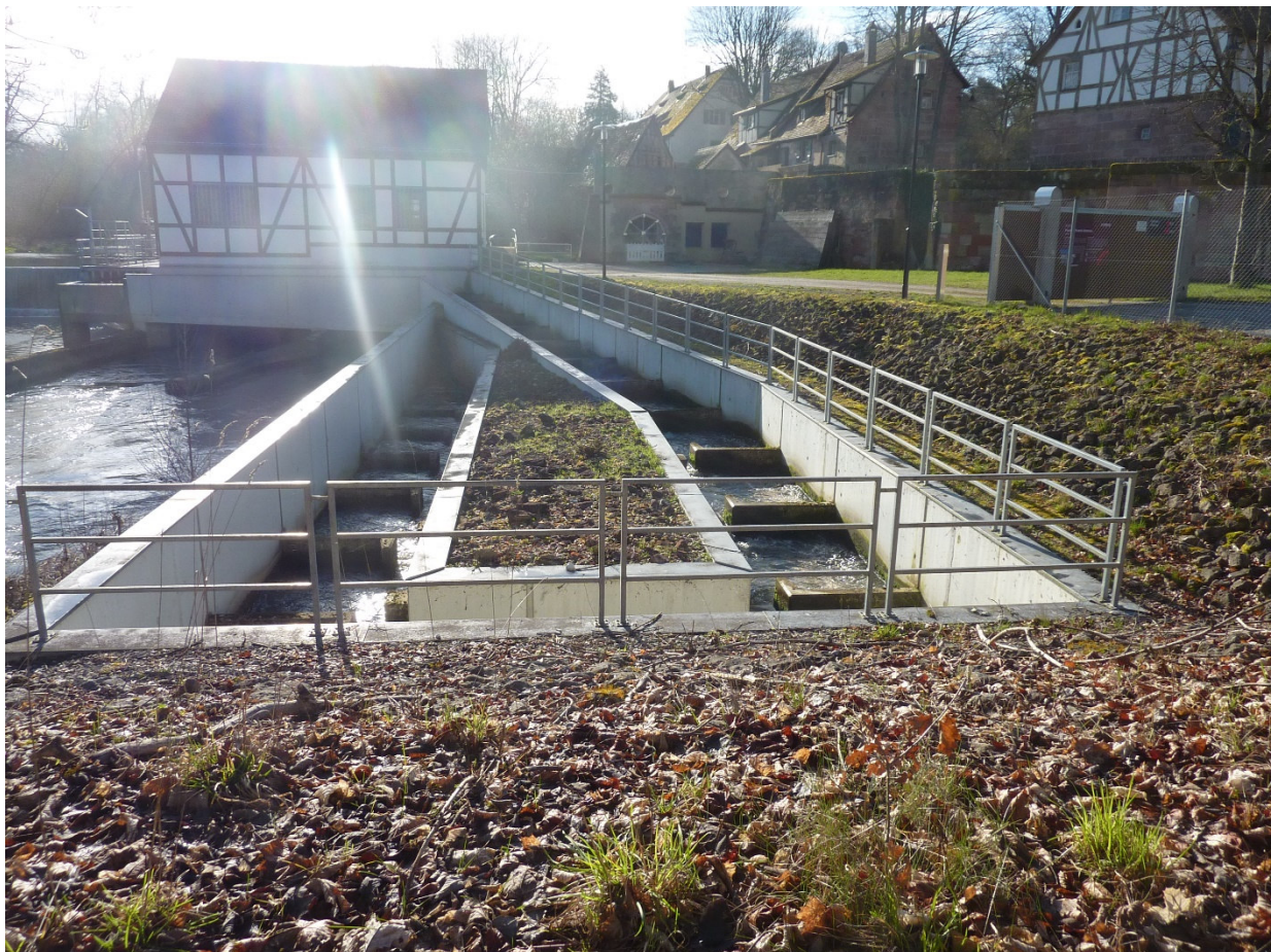
Abb. 4: Fischaufstiegsanlage am der Wasserkraftanlage Am Hammer
